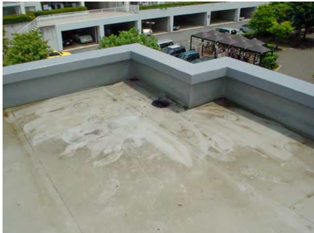
6 番館東側清掃後、水溜りが出来ていたのが確認できる
