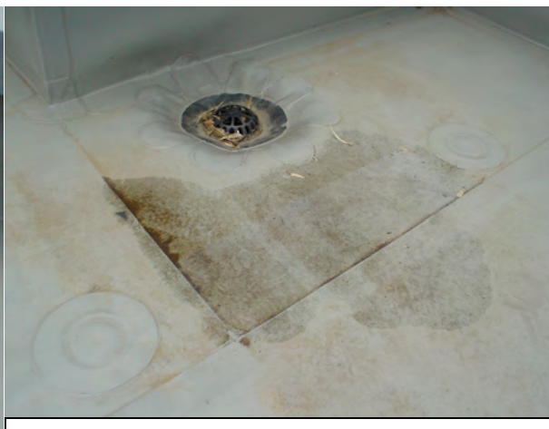
7 番館中央、水溜りが出来ている
