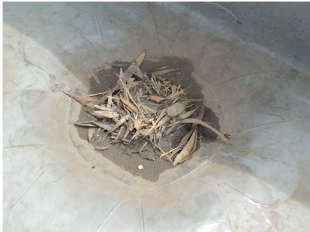
7 番館東側、清掃前は完全に詰まっている
