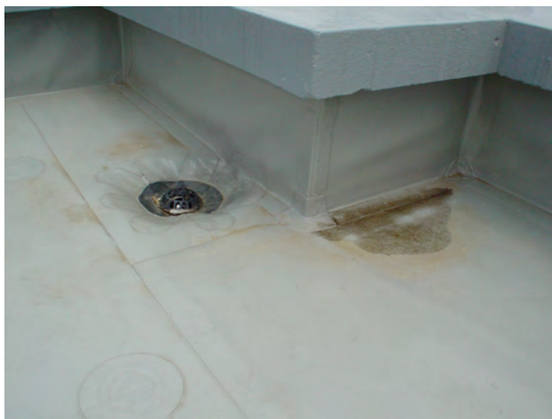
7 番館中央、水溜りが出来ている
